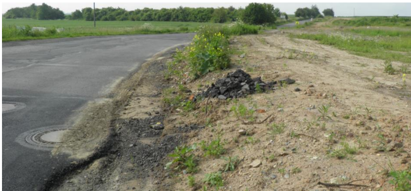
FOTO – Škvorecká ulice, voda splachuje zeminu do městské kanalizace
